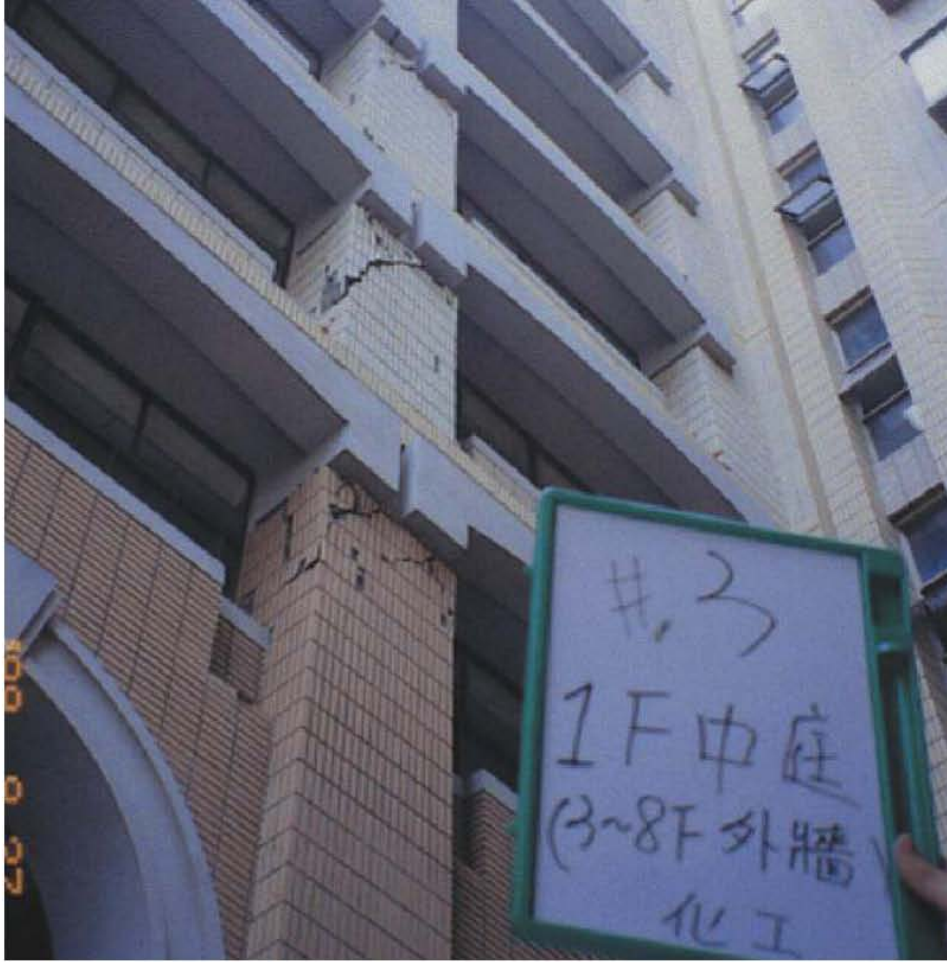
九二一地震後化材館一樓中庭外部磁磚 牆壁龜裂剝落
